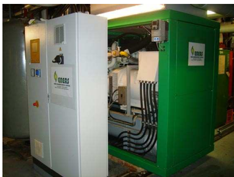
Figura 3 Hotelul Amigo Bruxelles: instalația de cogenerare din centrala termică (sursa: Bruxelles Environnement, Info Fiche Energie, IBGE, Bruxelles, Belgia, 2007)
