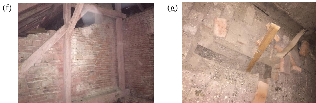
Fig. 1. Imagini ale clădirii 2 (a) Fațada SE – fațada principală; (b) Fațada NV; (c) Acces secundar, fațada NV; (d) Planșeu terasă circulabilă peste parter; (e) Tencuială exterioară, fațada SE; (f) Pereți spre spațiu neîncălzit (dinspre casa scării spre pod); (g) Stratificație planșeu de pod
