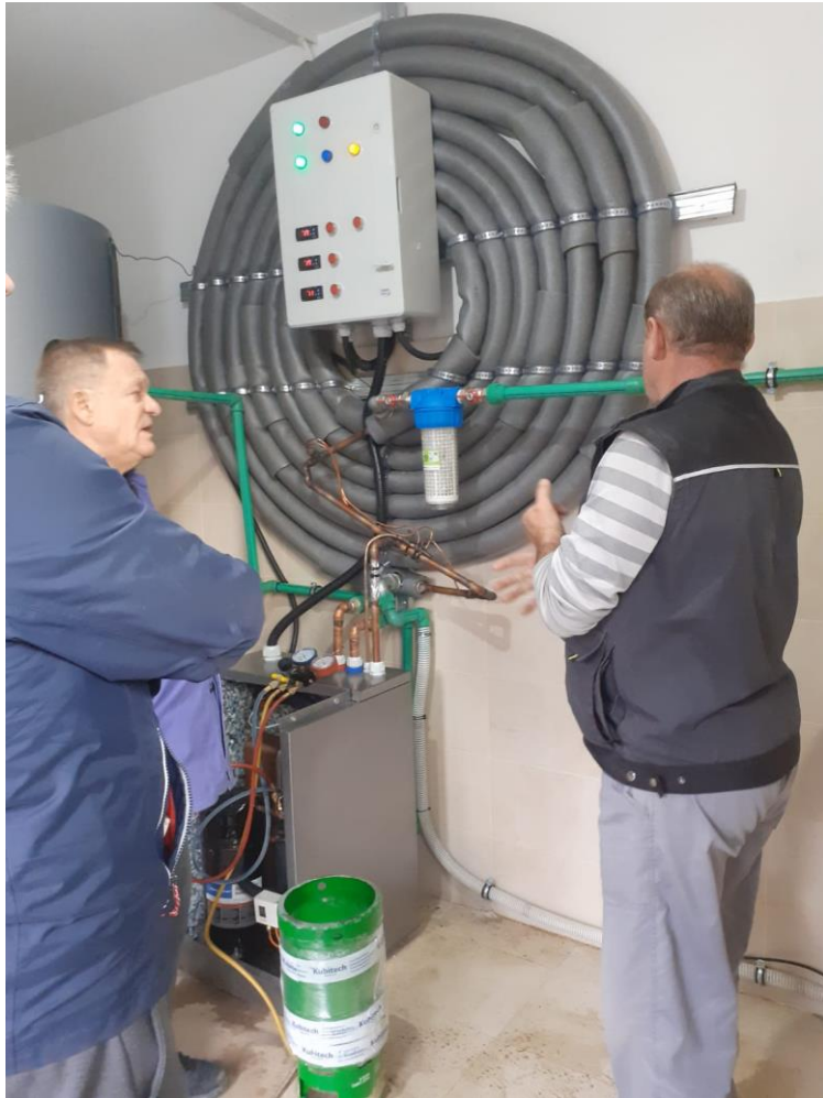
Pompa de caldura ASG montata in anul 2019 in Zalau judetul Salaj
